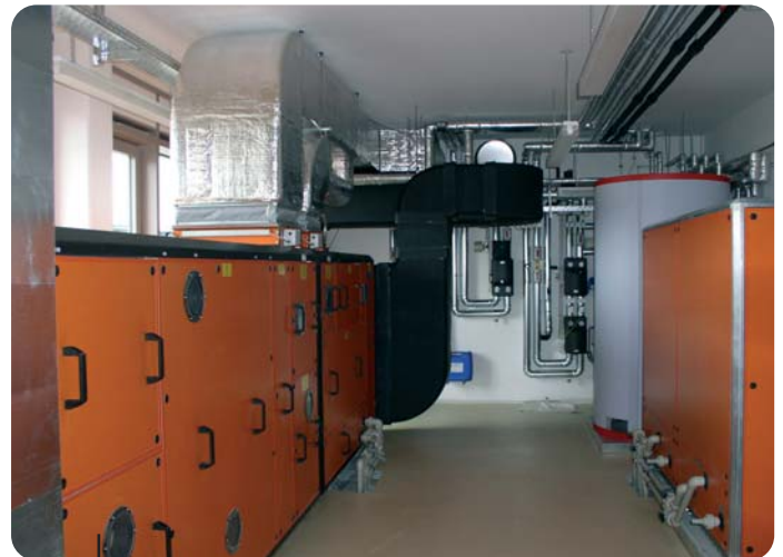
Figure 16 Système utilisant un matériau déshydratant liquide installé dans le nouveau bâtiment du Centre d'Innovation Solaire (SOBIC) à Fribourg en Allemagne
