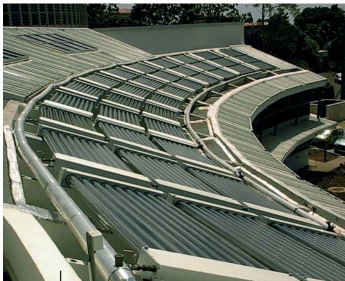
Figure 18 Intégration des capteurs solaires sur le toit de la DIREN (Guadeloupe, France)
