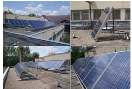
Fig2) Parc énergétique à Dédestopolcsány
